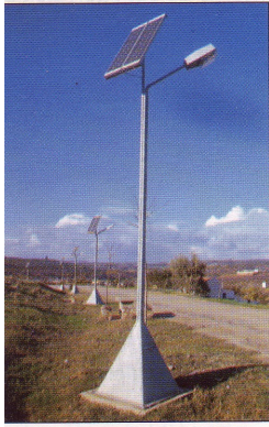
Fig. 12. Energía solar para el alumbrado.
